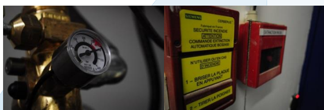
Sécurité Incendie & Inondation du DataCenter Ikoula
